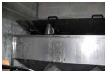
Bac de décantation
