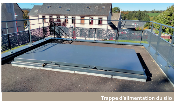
Trappe d'alimentation du silo
