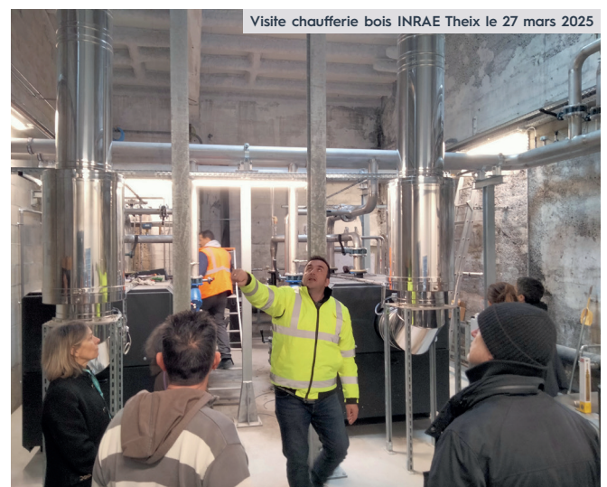
Visite chaufferie bois INRAE Theix le 27 mars 2025
